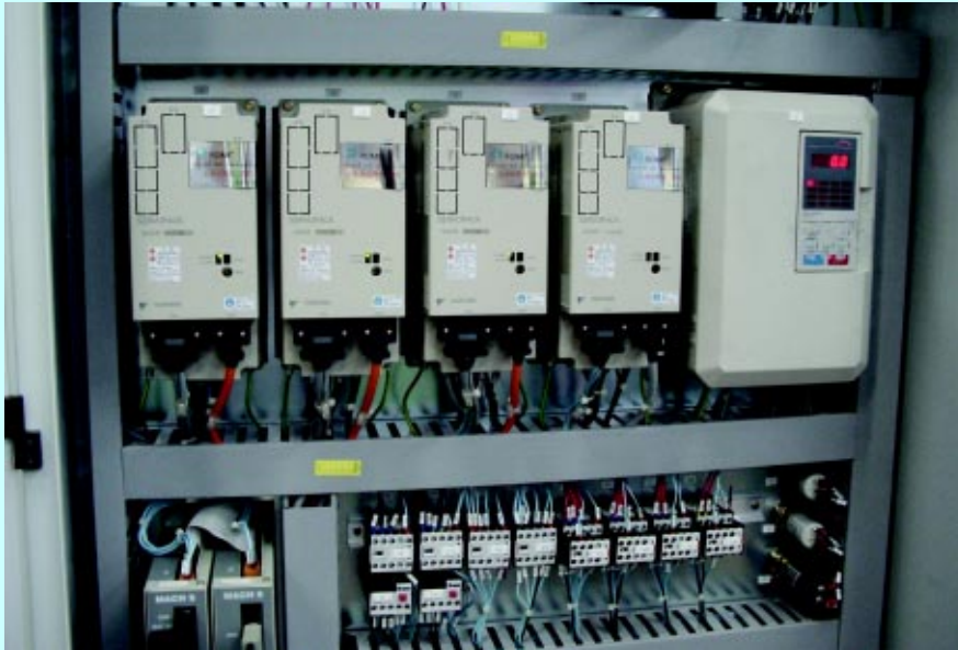
Figura 10 - Inversor de frequência em um centro de usinagem.
