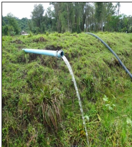
Figura 11 - Entrada de água por cano
