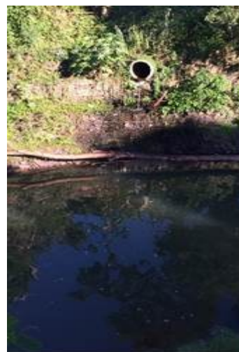
Figura 21 - Descarga proveniente da drenagem pluvial.
